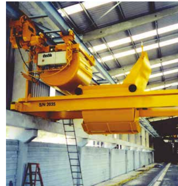
Automatische Nachfahrt zum Verteiler
